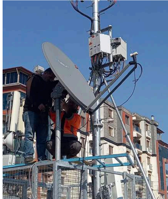
GSM Baz İstasyonu VSAT Kurulumu
